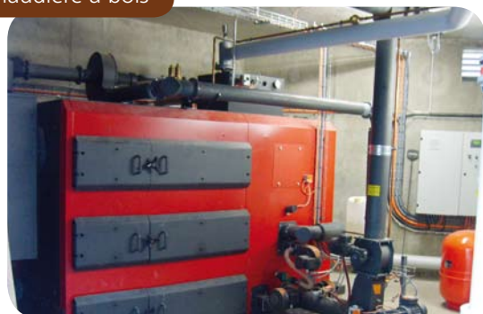
Chaudière à bois
