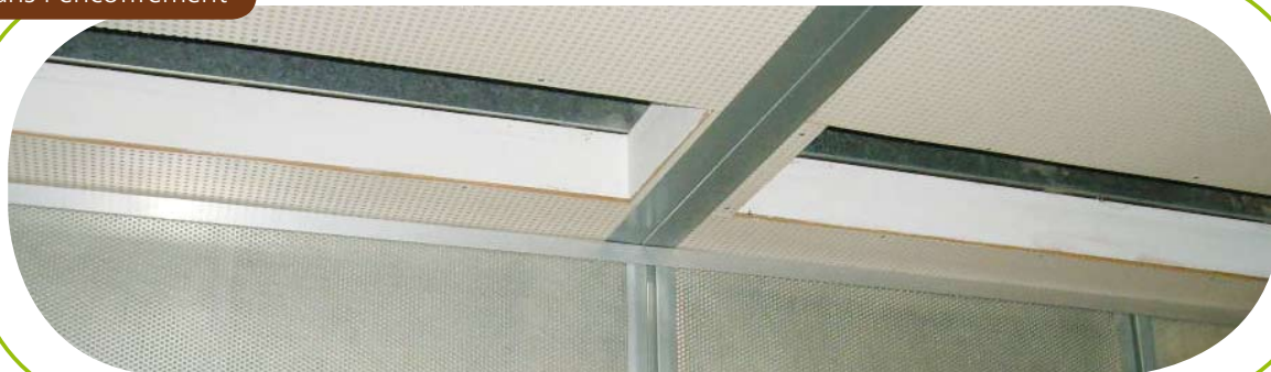
Diffuseurs d'air neuf dans l'encoffrement
